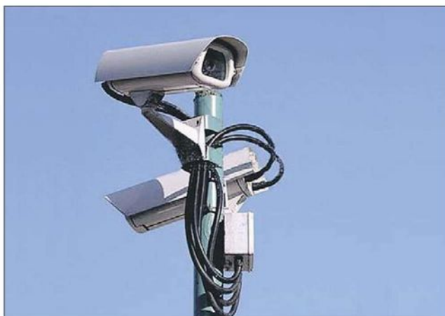
Nuove telecamere in arrivo Le prime saranno montate entro settembre
